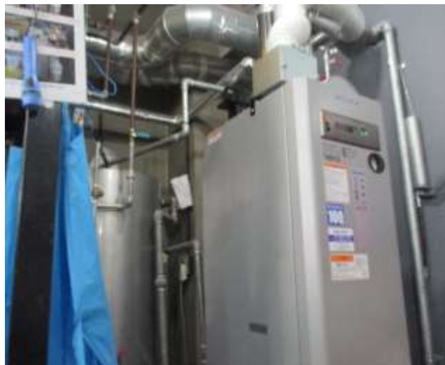
クリーニングの心臓・ボイラーです
